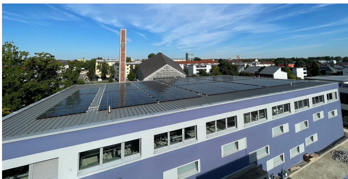
PV-Anlage auf dem Dach der Ballspielhalle der Wilhelm-Ernst-Grundschule
